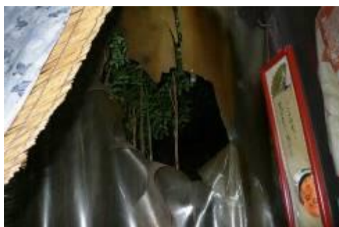
改修前の破れた中庭カーテン
